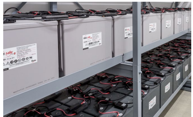
Batterien für eine unterbrechungsfreie Stromversorgung
