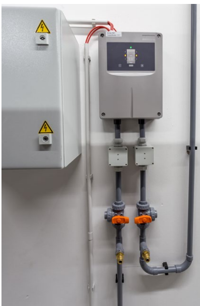
Brandschutz/Früherkennung: Brandmeldeanlage, Rauchsaugsystem mit Lasererkennung, direkte Aufschaltung zur Feuerwehr
