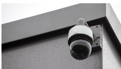
Kameraüberwachung mit Aufzeichnung in allen Räumen und Außen-Videoüberwachung
