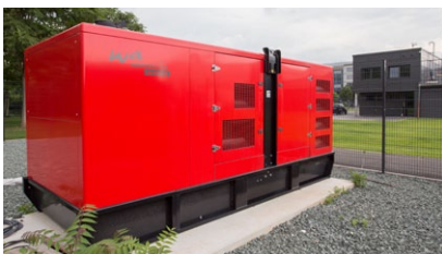
Dieselgeneratoren: 15.000L Kraftstoffvorrat
